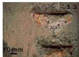
Rust i armering, skadesgrad 3
